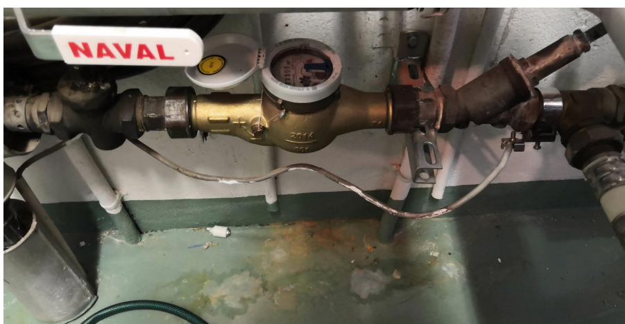
Kuva 2. Päävesimittari Aunelan puolella
