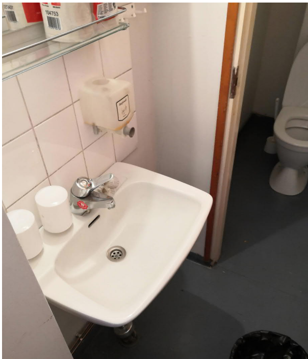
Kuva 3. WC-tilassa vanha Oraksen yksiotehana sekä pesuallas, taustalla uusittu WC-istuin.
